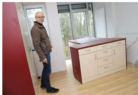
Technischer Leiter Peter Kerkmann beim Baustellenrundgang. In den Apartments werden die Möbel eingebaut.
