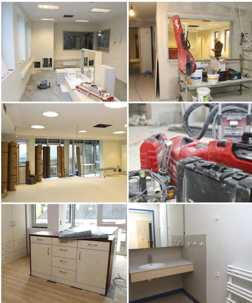
Die Baustelle brummt: Der neue Pflegestützpunkt (Bilder oben) wird hergerichtet, im Wohn-Esszimmer (Mitte) steht schon der Bodenbelag verlegebereit. Unten: Apartment mit fertiger Nasszelle.
