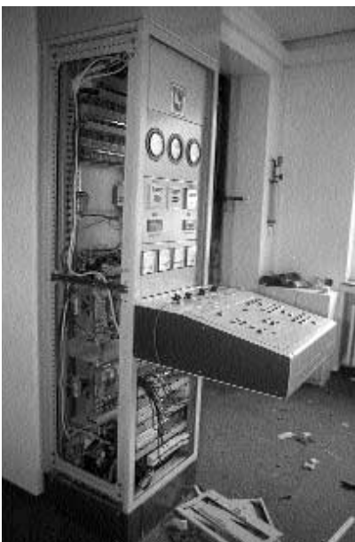
Hinter dem nüchternen Grau des Schaltpults verbirgt sich ein undurchdringliches Kabelgewirr.
