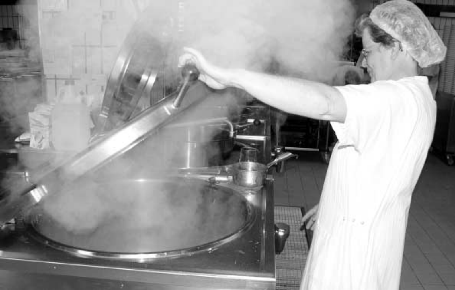
Die Küche des St. Josef-Stifts hat in den vergangenen Jahren eine Vielzahl zusätzlicher Aufgaben übernommen. Jetzt wird sie technisch und baulich auf den neuesten Stand gebracht.
